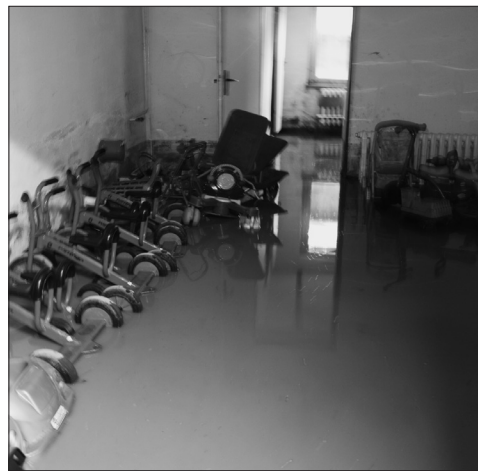
Viele Räume des Kindergartens standen unter Wasser
